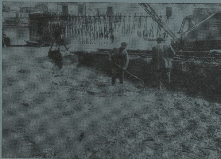
Toen vorige week de vissershaven van Oostende een grondige kuisbeurt kreeg, bleek vooral de slipway zeer vervuild met slijk. Op de foto bemerkt men werklieden die het slijk aan het opruimen zijn. (Foto Michaël)
