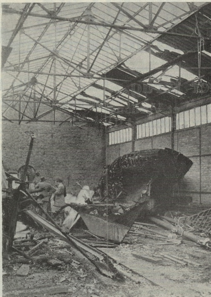
Een binnenzicht op de uitgebrande werkplaats
