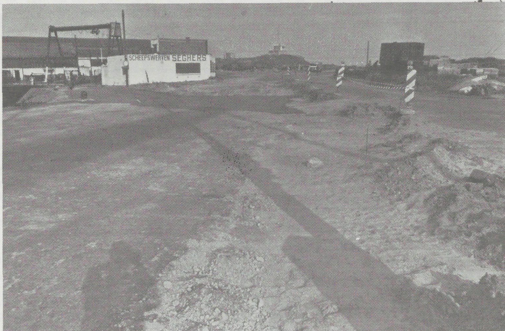
De werken aan de nieuwe weg in de buurt van de Vuurtoren. Een verspilling van veel geld, daar waar dit op een andere en veel nuttiger manier kon gespendeerd worden.
