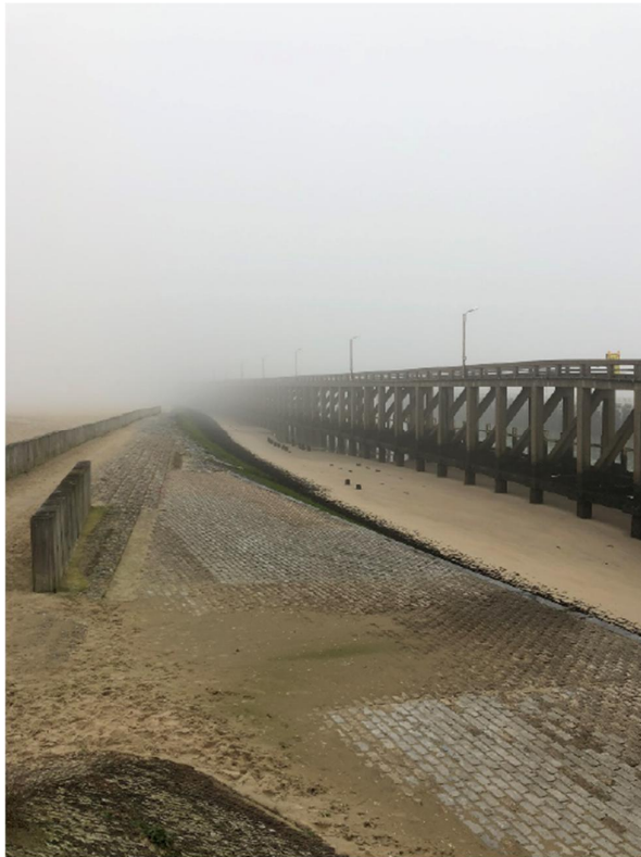
Figuur 6-1 Huidige situatie staketsel met dam (SBE, 2020)
