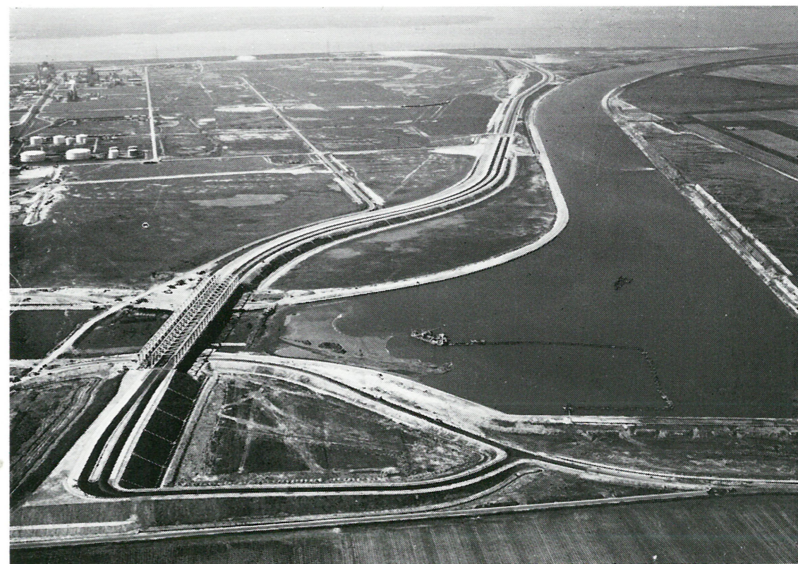
Photo 2. — Vue du bief supérieur à hauteur de la frontière belgo-néerlandaise avec, à l'arrière-plan, l'Escaut occidental. Les travaux de dragage sont en cours (avril 1975).
