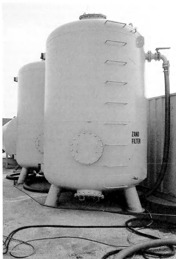
Foto 13. — Waterzuiveringsinstallatie 2e trap: filtratie (zand).
