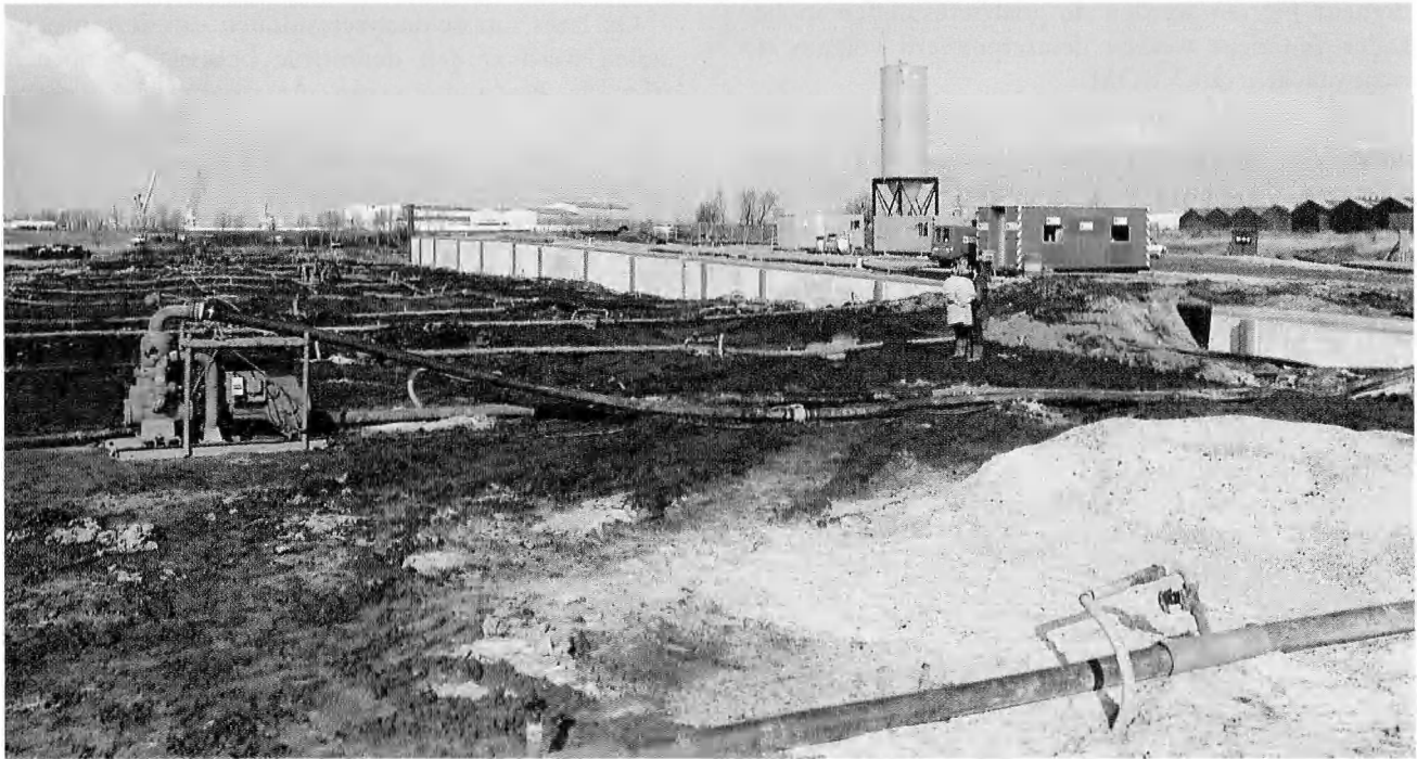
Foto 7. — Een meer gedetailleerd beeld van de batterijen waarop de bemalingsfilters zijn aangesloten. Ook een duidelijk beeld van de nieuwe kaaimuur.
