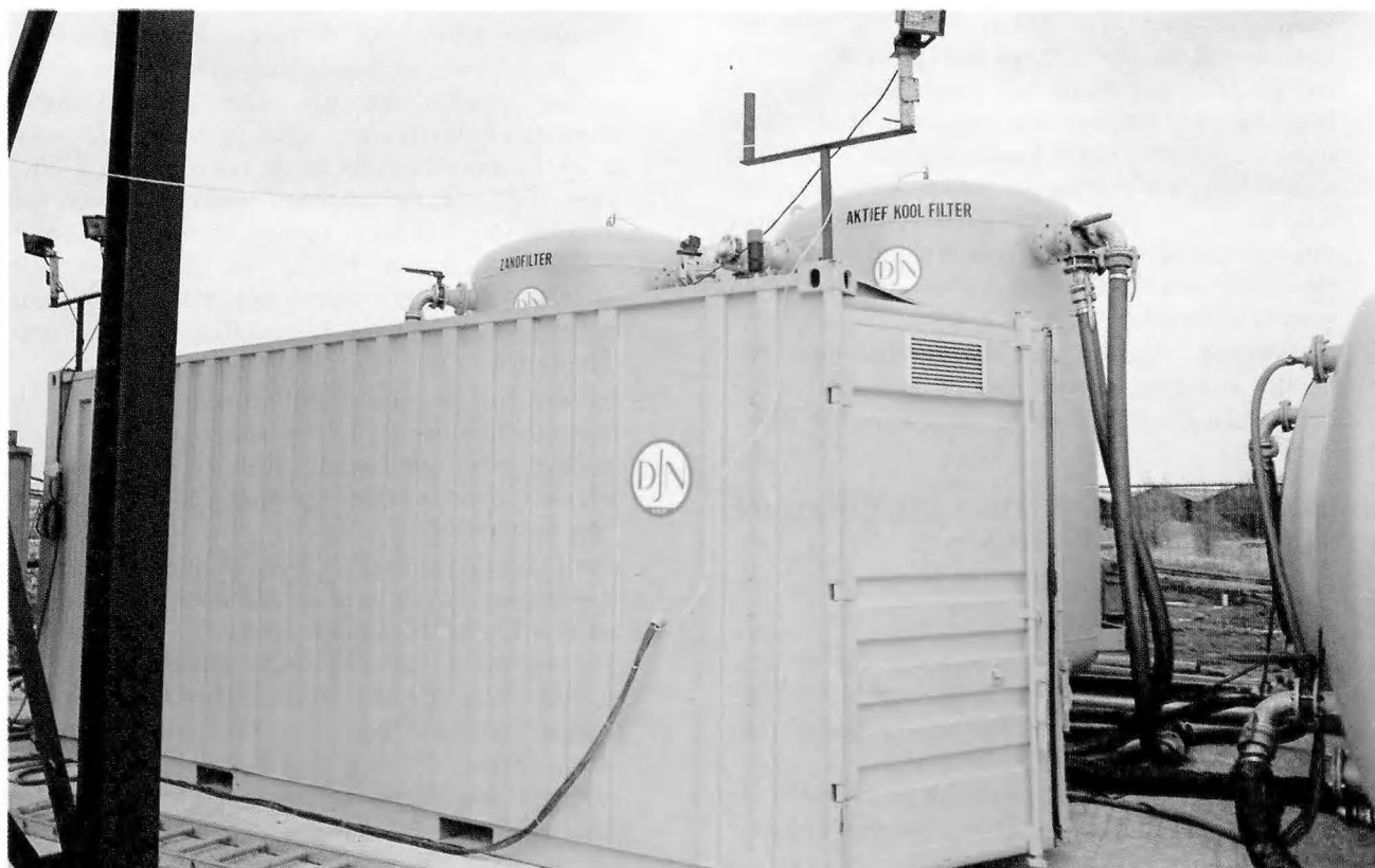
Foto 14. — Waterzuiveringsinstallatie 2e trap filtratie (actieve kool).
