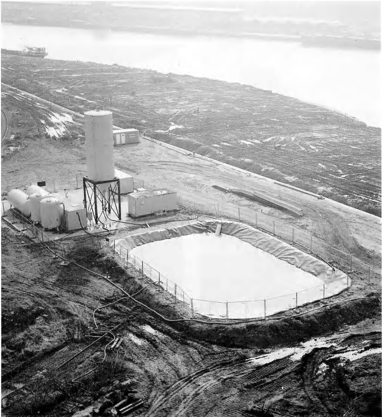
Foto 10. — De mobiele waterzuiveringsinstallatie, opgebouwd uit verschillende modules. Op de voorgrond het bufferbekken, op de achtergrond de gronden waarop 269 bemalingsfilters werden geplaatst.
