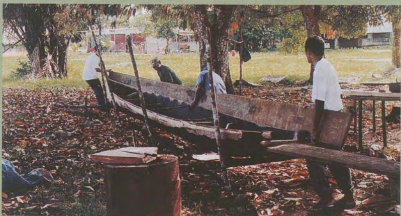
Fixation des bordages : les côtés rehaussés d'une cinquantaine de centimètres, la coque est bientôt prête à affronter les flots.
