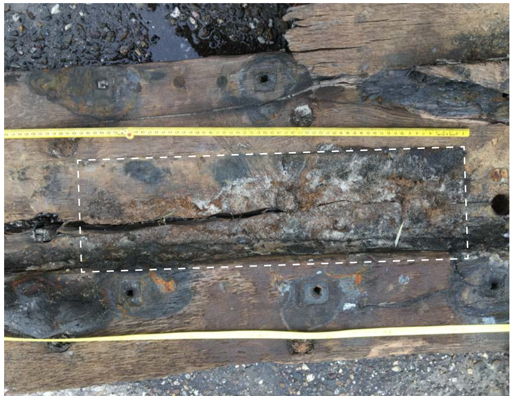
Afb. 5.35 Rechthoekige plek met mosbreeuwsel op huidgang vnr V12-B. Hier heeft een reparatieplank gezeten, die niet meer aanwezig was.
