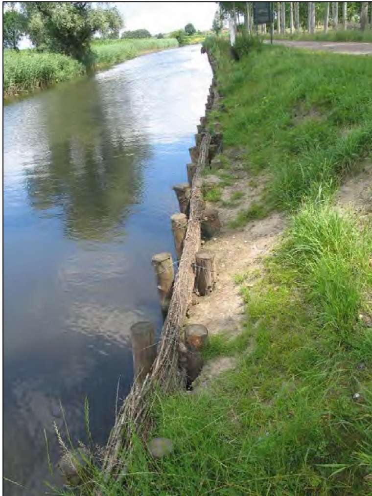
Foto 6. Constructie ter hoogte van de Coudenbormbrug (LO). Door de palen en wiepen tegen de oever te plaatsen, krijgt men een abrupte overgang tussen het land- en oevermilieu waardoor water- en moerasvegetaties zich niet of moeilijk kunnen vestigen. Een gesloten oeververdediging vormt ook een barrière voor faun indien er niet op geregelde afstanden openingen voorzien worden.
