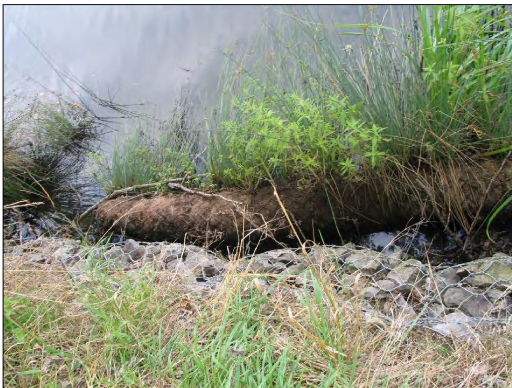
Foto 5. Constructie op het traject Pieter Heydensveer-Zuidlede (LO). Op dit traject komen op veel plaatsen de kokosrollen los en kantelen ze in het water.
