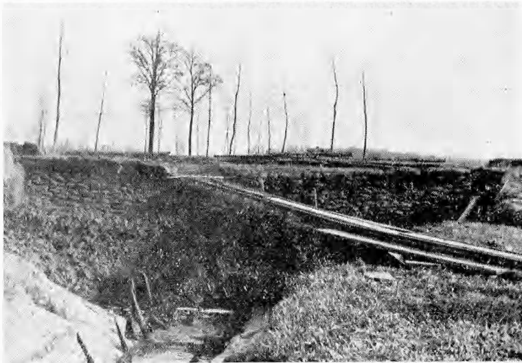
Bres in Potpolder VI te Lokeren, April 1943, ten gevolge van de instorting van een privaat sluisje. De kern in zakken is juist opgetrokken.
