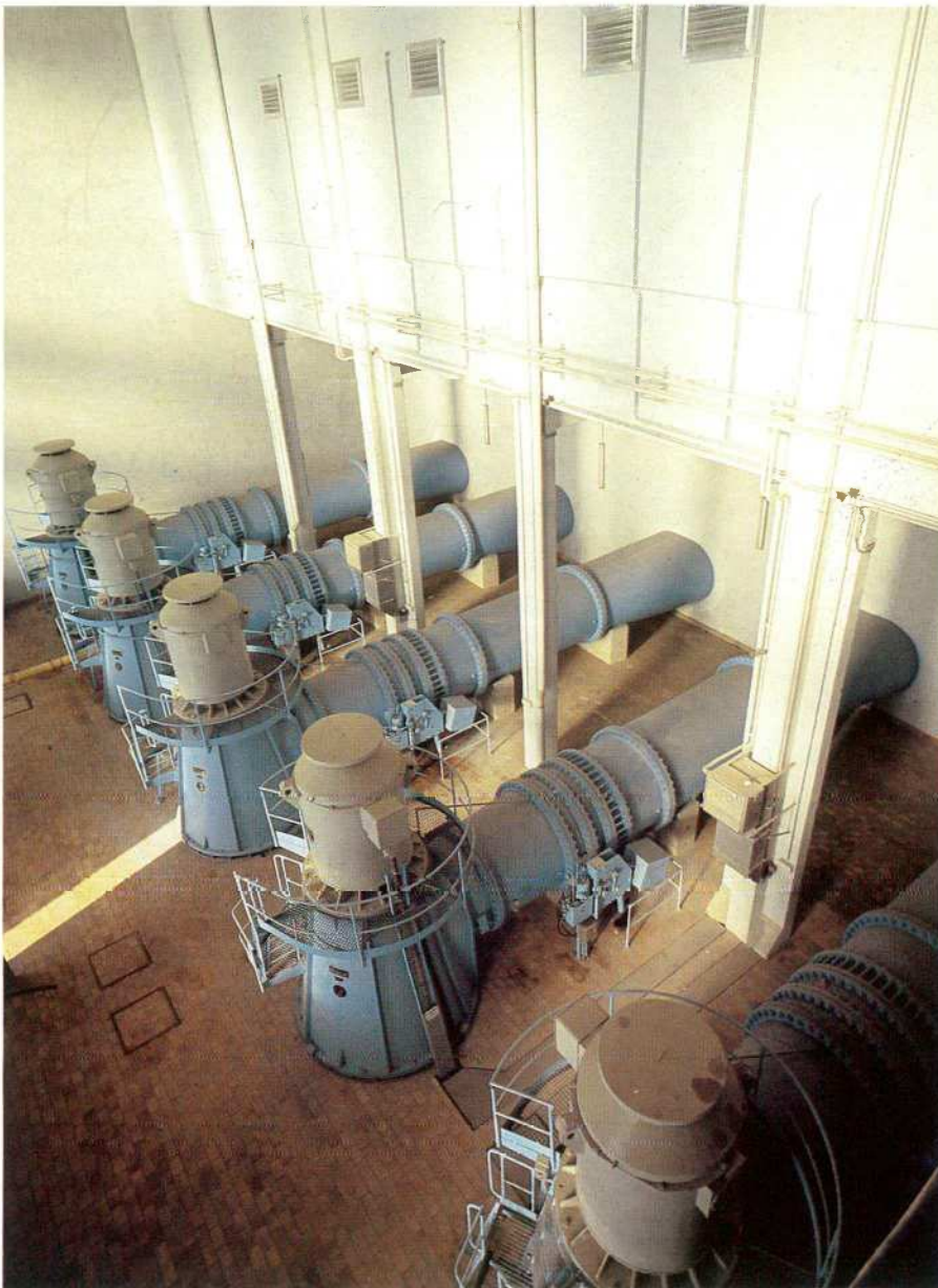
Station de pompage de l'écluse de Zemst
