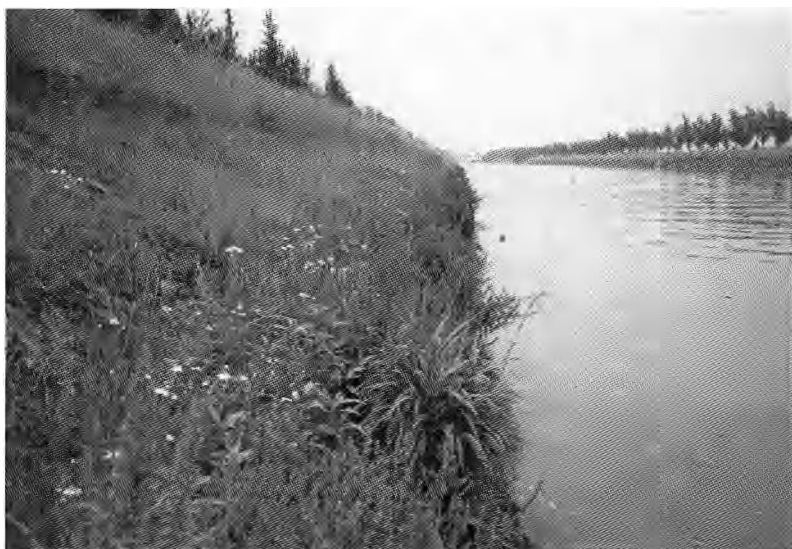
Foto 2. — Klassieke Leie-oeverprofiel, hersteld met gevezelde open steenasfalt op geotextiel in situ en als prefabmatten onder de waterlijn, nadien bedekt met teelaarde en ingezaaid.
