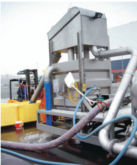
Abb. 4: Wasserabscheider mit Auffangtank für die Rückführung zum Fangschiff - Water separator with return water tank and exhaust hose to the cutter.
