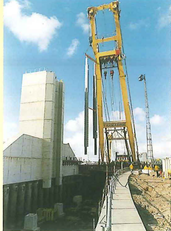
De stalen geleiderail wordt in de geleidetoren aangebracht. Deze stelt de locomobiel in staat op en neer te bewegen.
